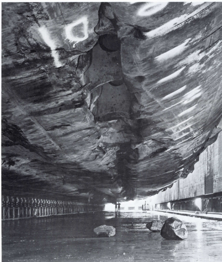
En drygt 100 meter lång spricka revs upp i Arctic Wasas bottenplåtar vid grundstötningen. När fartyget dockades på Kockums lossnade stenbumlingarna som syns på bilden.
