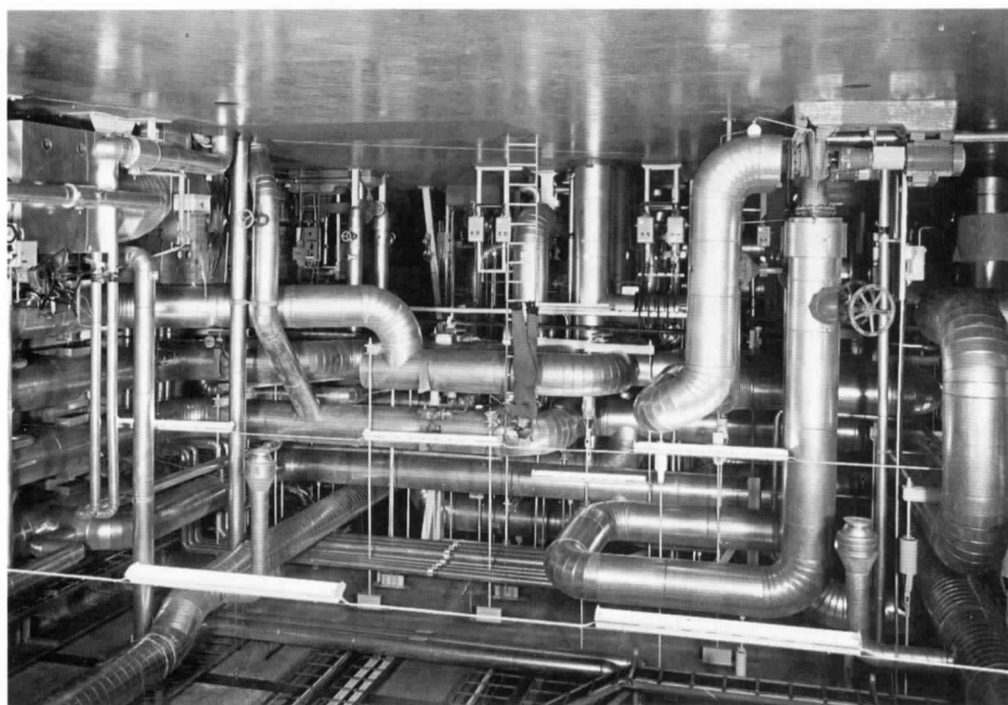
Pumpar och rörledningar för fjärrvärmedistribution i pumphallen vid kraftvärmeverket i Växjö.
