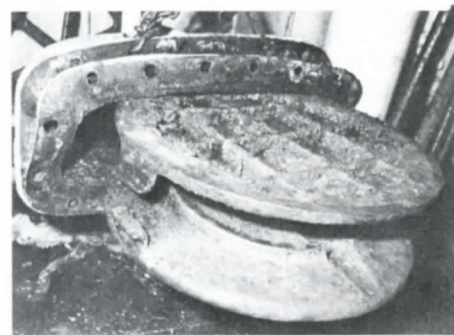
Boven i dramat: avloppsventilen som inte var stängd.
